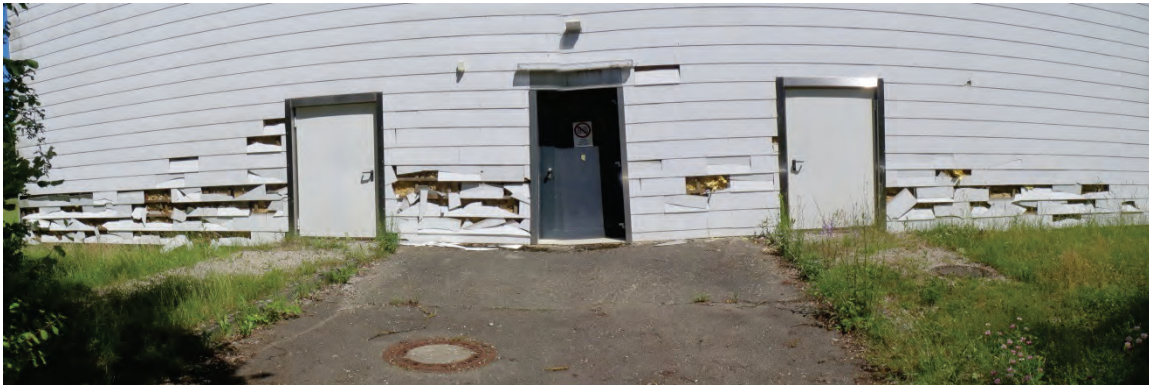
Abb. 8: Südfront Turnhalle (Gebäude 15) mit aufgebrochenen Platten und Dämmmaterial
