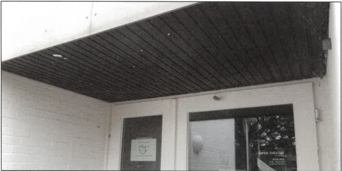
Abbildung 4: Dachüberstand an den Eingängen. Völlig abgedichtete Konstruktion (31.07.2022).
