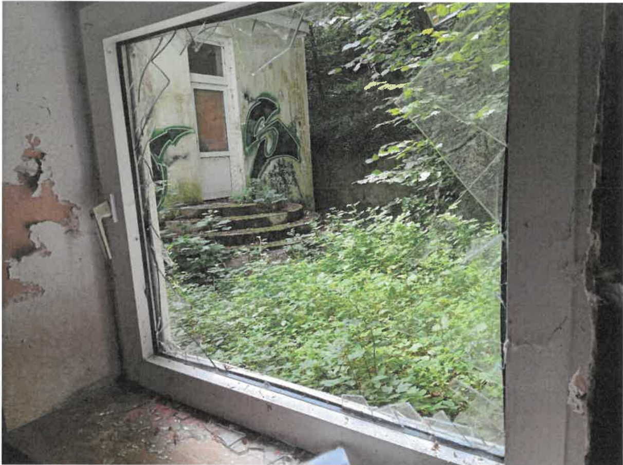
Abbildung 3: Eingeworfene Scheibe im Treppenhaus auf halber Höhe zum 1. Stock. Dieses Fenster wurde mit Brettern verschlossen.
