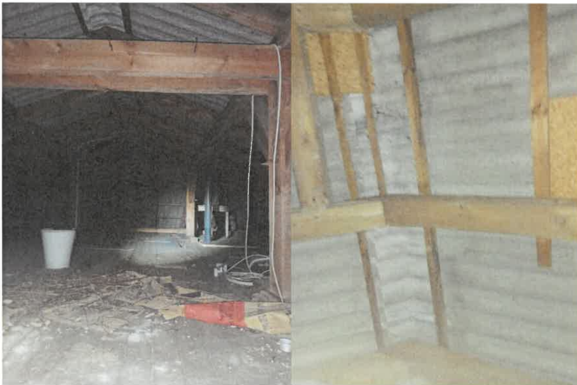
Abbildung 2: links: Dachboden, auf dem keine Spuren von Vogel-, Fledermaus- oder sonstiger Besatz gefunden wurde. rechts: Wellblechdach liegt direkt auf dem Dachstuhl auf, geringes Potenzial für Fledermäuse im Winter.
