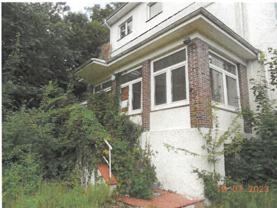
Abbildung 3: Blick auf überwucherte Treppe zur Terrasse von Süden
