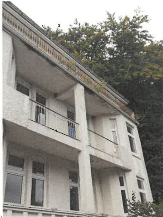
Abbildung 2: Blick von Osten auf Balkone der Villa, zu sehen sind zwei Mehlschwalbennester am 2. Stock
