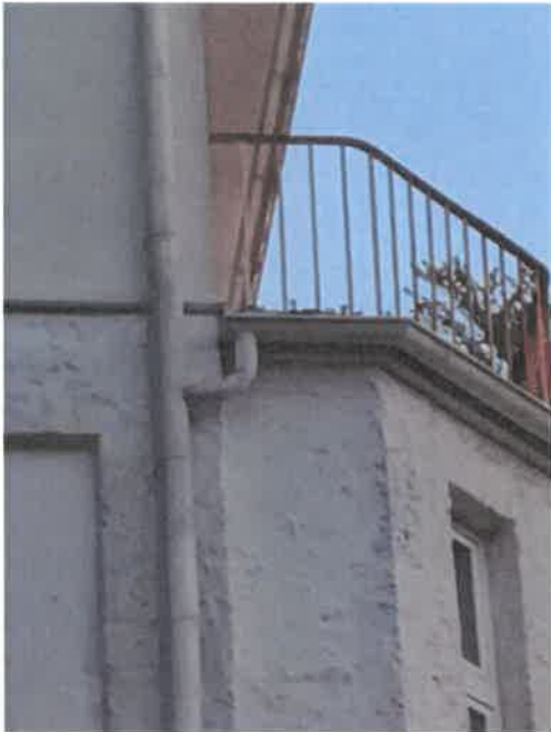
Abbildung 12: Einflugstelle der Mückenfledermäuse, vermutlich hinter der Stelle, an der Regenfallrohr und Regenrinne aufeinandertreffen.
