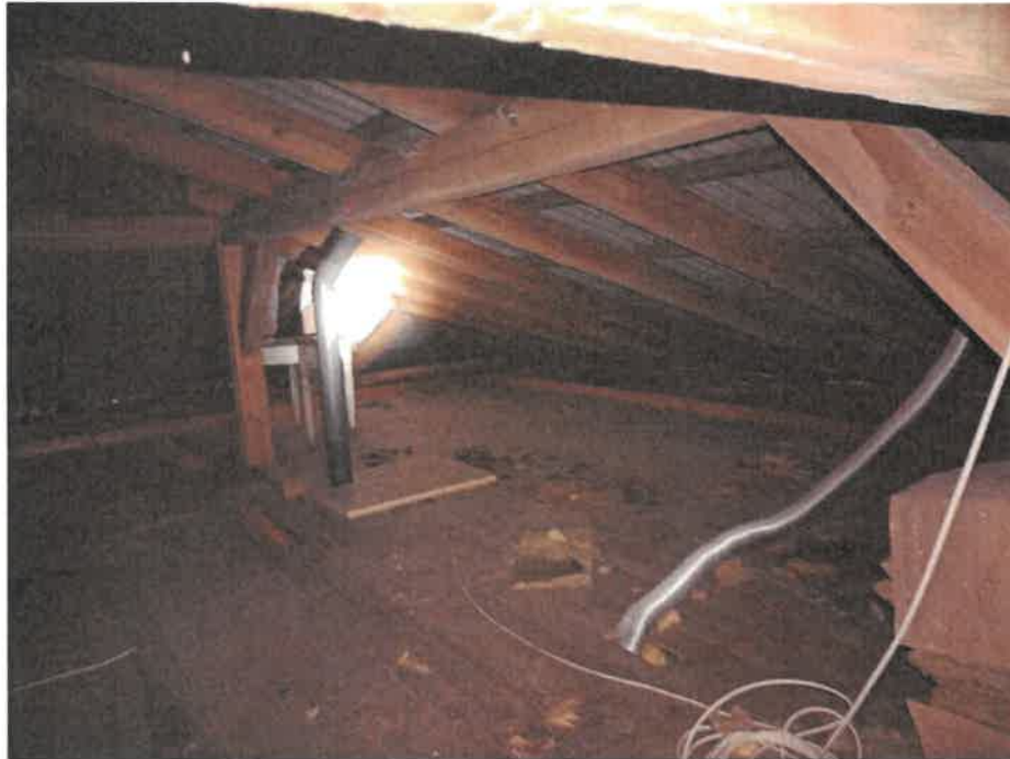
Abbildung 8: Dachboden, schwer einsehbar mit morschem Boden.
