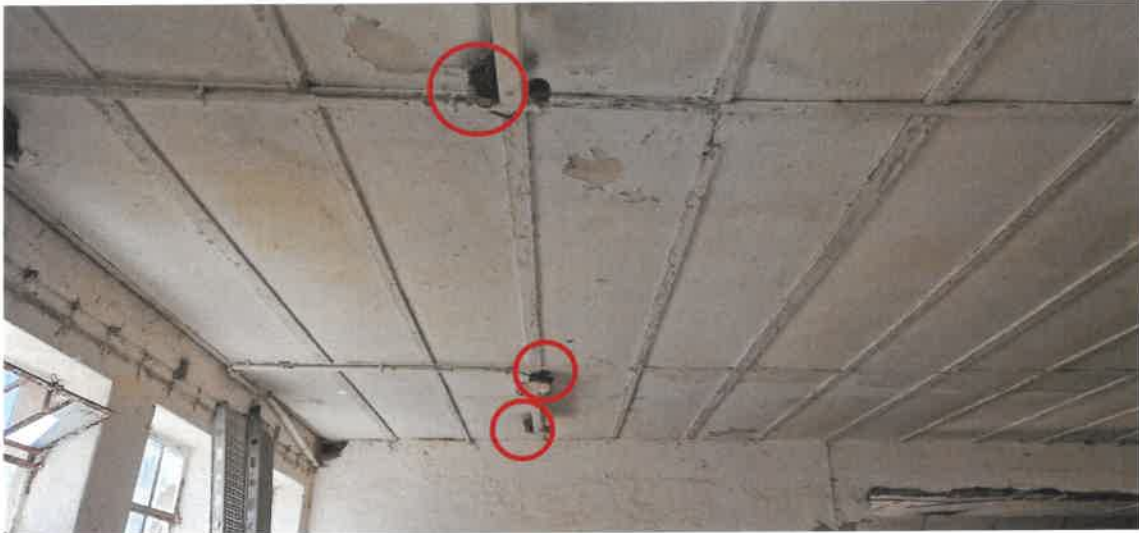
Abbildung 39: Rauchschnalbenester an Lampen in Gebäude 1.
