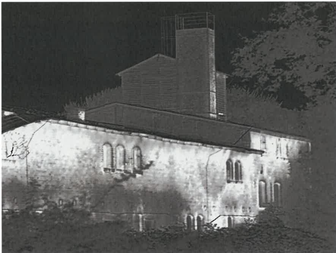
Abbildung 47: Nordwestseite von Gebäude 2 im Wärmebild.
