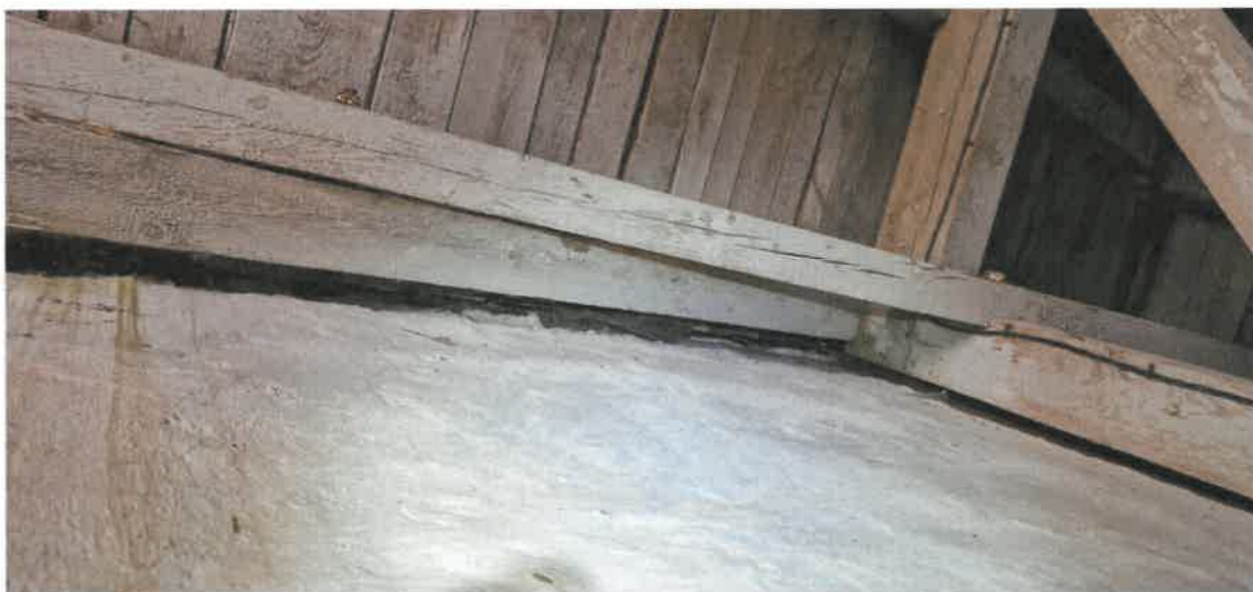
Abbildung 25: Einzelne Kotsuren am Übergangsbereich zum südlichen Teil von Gebäude 2.
