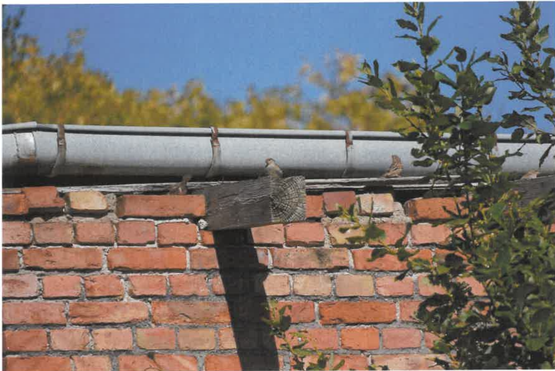
Abbildung 44: Haussperlinge an den defekten Dachbereichen von Gebäude 2.
