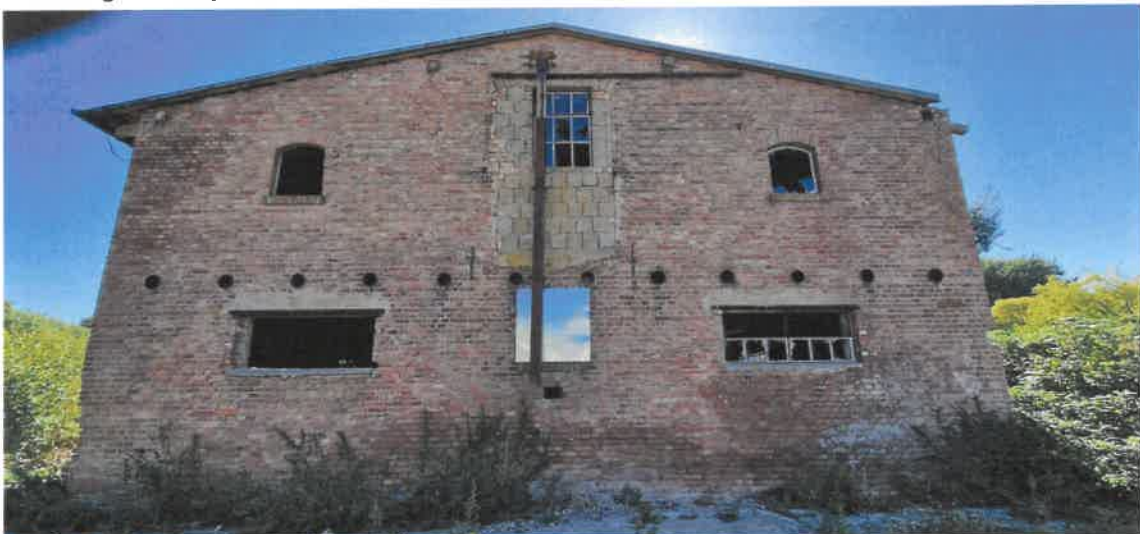
Abbildung 17: Nordostgiebel des Gebäudes 2 mit zahlreichen Spalten.
