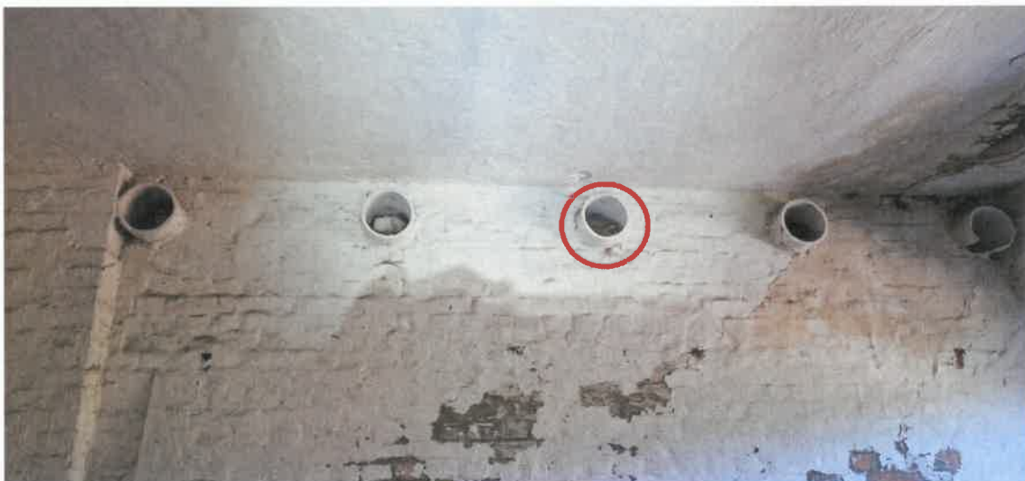
Abbildung 32: Die Röhren in den Wänden waren teilweise mit Nestern belegt.
