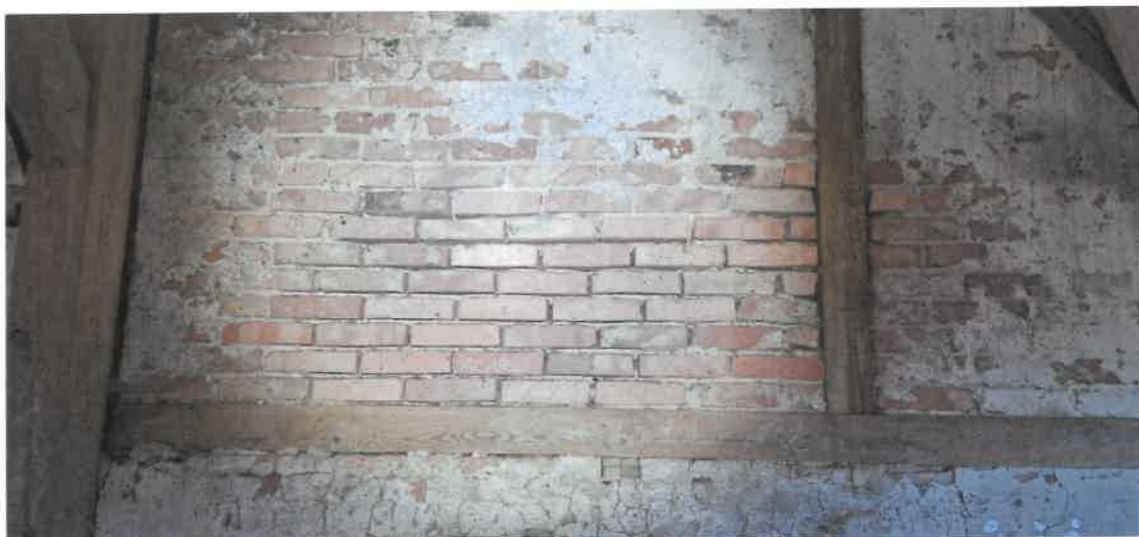
Abbildung 23: Südwestgiebel mit Spalten in Gebäude 2.
