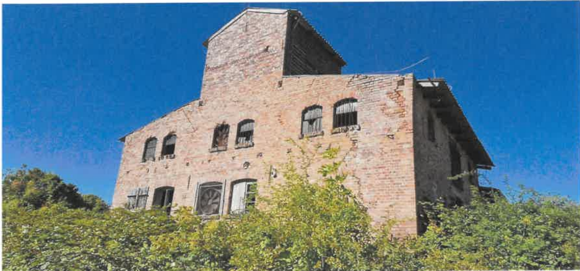
Abbildung 27: der Südwestgiebel an Gebäude 2 weist ebenfalls viele Spalten und Risse auf.
