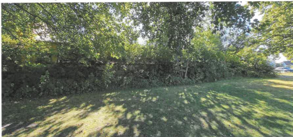
Abbildung 41: Die Nordostseite von Gebäude 1 ist von Gebüschern zugewachsen.
