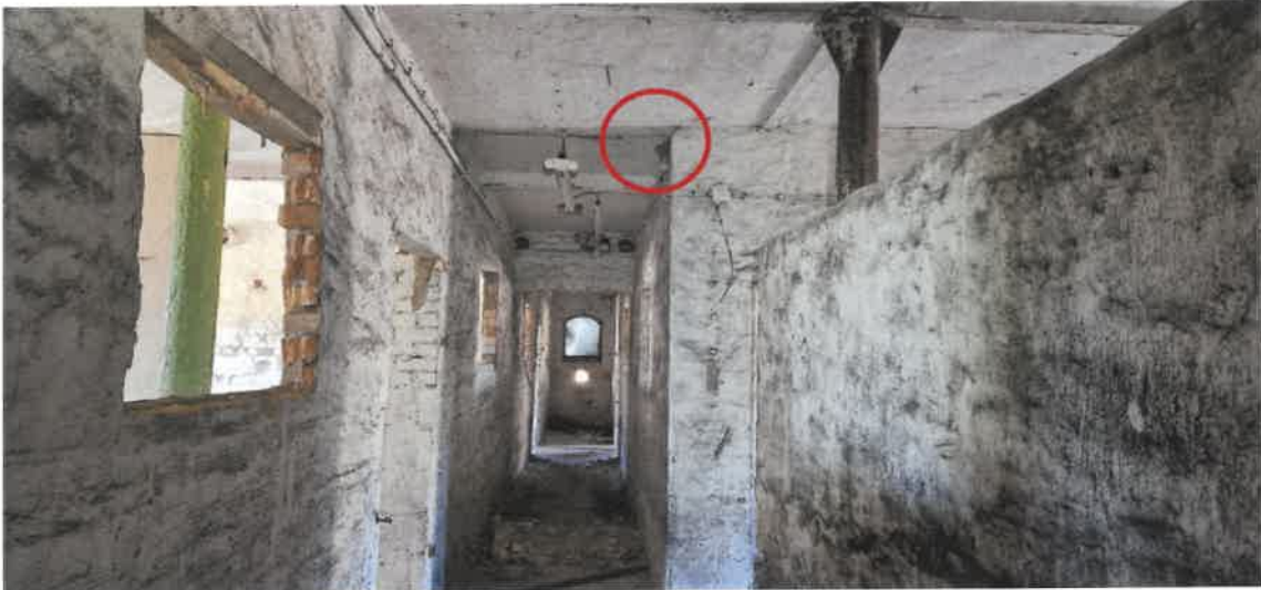
Abbildung 33: Erdgeschoss in Gebäude 2, an vielen Stellen befanden sich Rauchschnalbenester.
