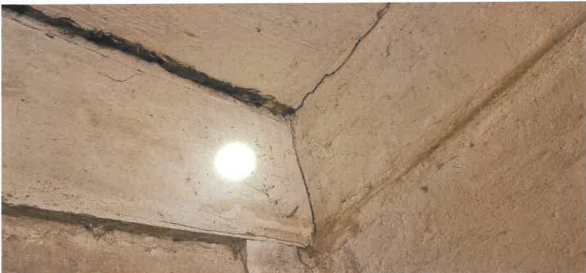
Abbildung 16: Kotspuren an der Wand in Gebäude 3.
