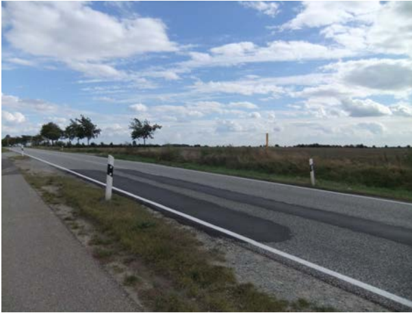
Nordwestliche Blickrichtung entlang der L 63 in Richtung BAB 14
