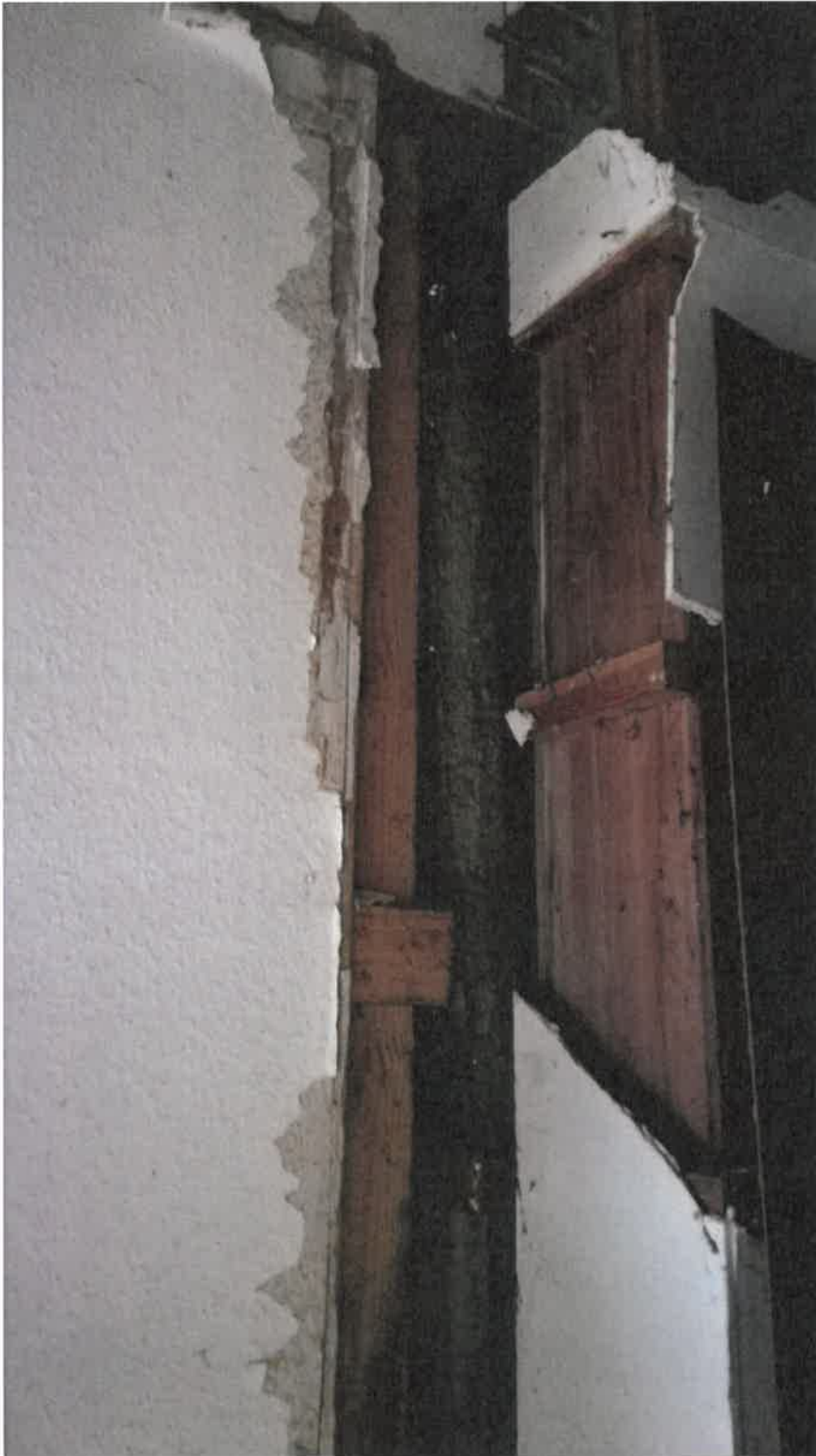
Vereinzelt sind Außenwände von innen beschädigt, eine Zugänglichkeit von außen besteht jedoch nicht
