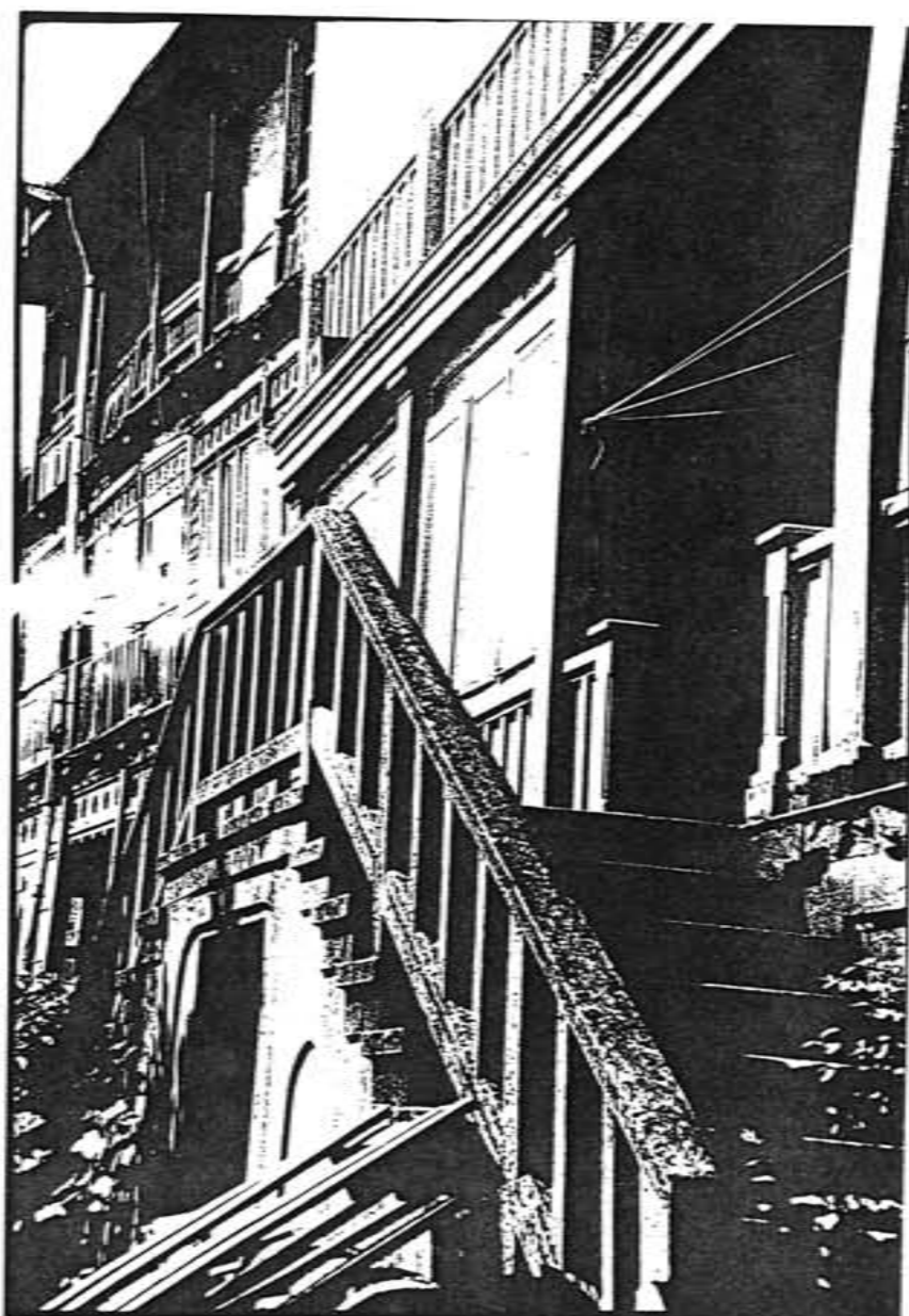
ABB. 2: TEIL EINER TREPPE AN EINER PENSION IN DER ROSENSTR., 1991
